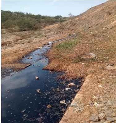
CUNETA DE LIXIVIADO
